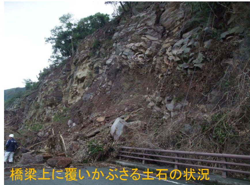
橋梁上に覆いかぶさる土石の状況
