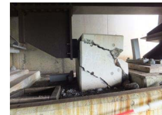
変位制限装置 せん断破壊
