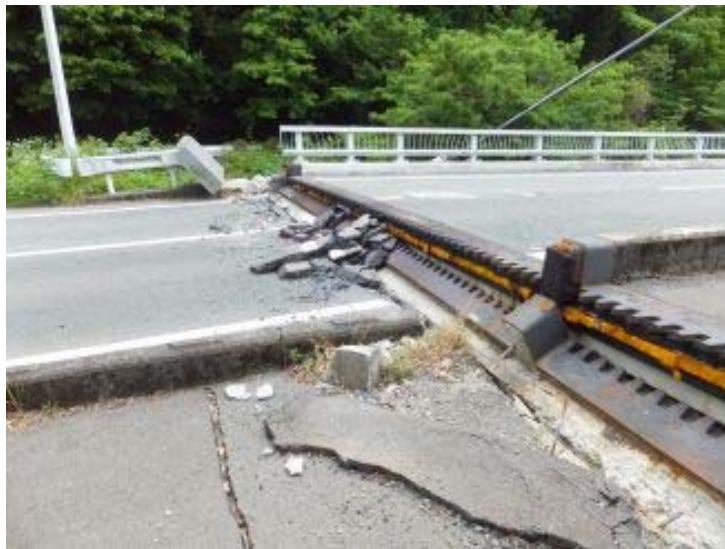
A2橋台側に発生した段差
