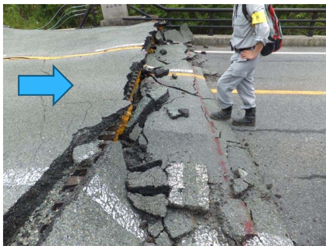
背面道路の乗上げ(約1m)
