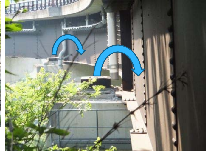
支承の損傷と主桁の横移動
