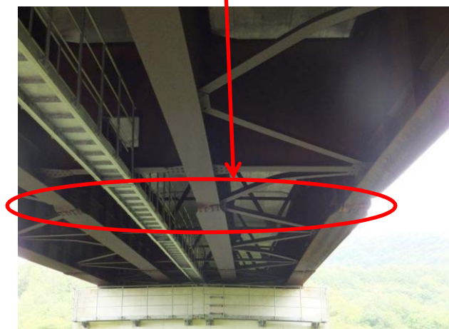
橋面の折れと下フランジの圧縮変形
