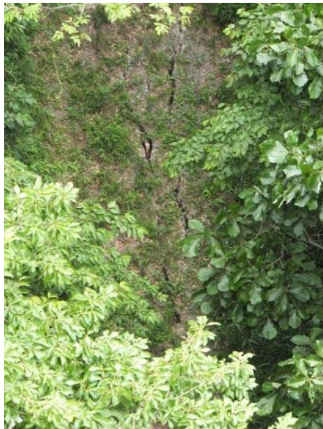
橋台前面には亀裂がある
