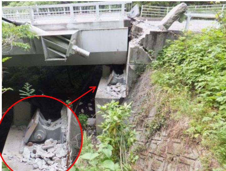
A2橋台は支承部の損傷大
