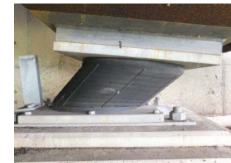
支承残留変位
