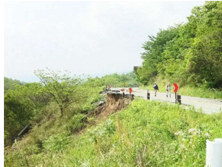
道路谷側斜面(盛土)の崩壊
