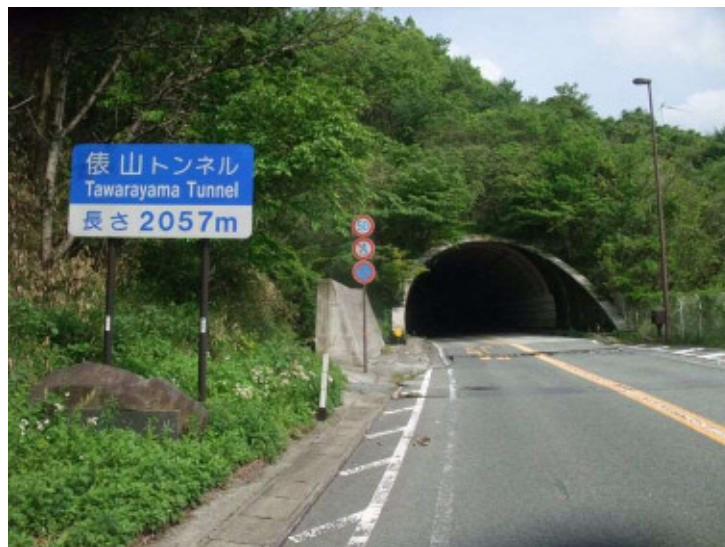
坑口直前の道路の変形
