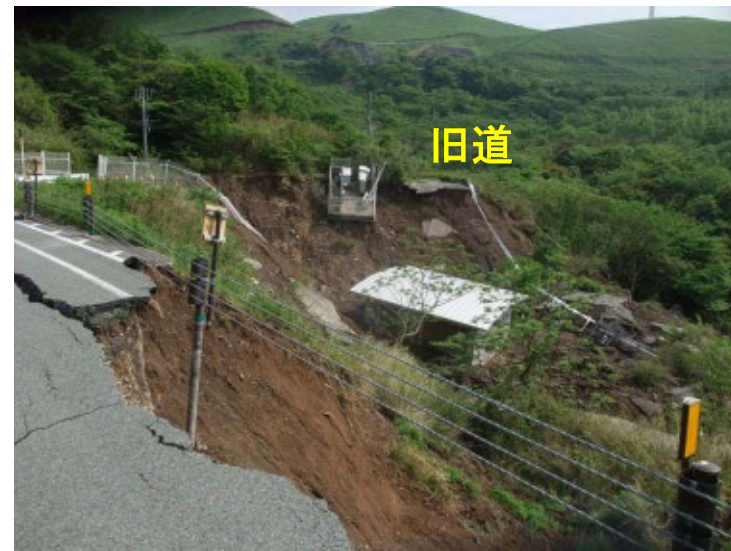
坑口直近の崩壊(旧道の流失)
