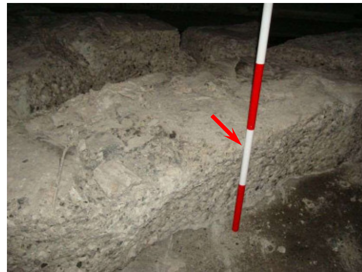
坑口から1600m付近 覆工コンクリートの落下状況
