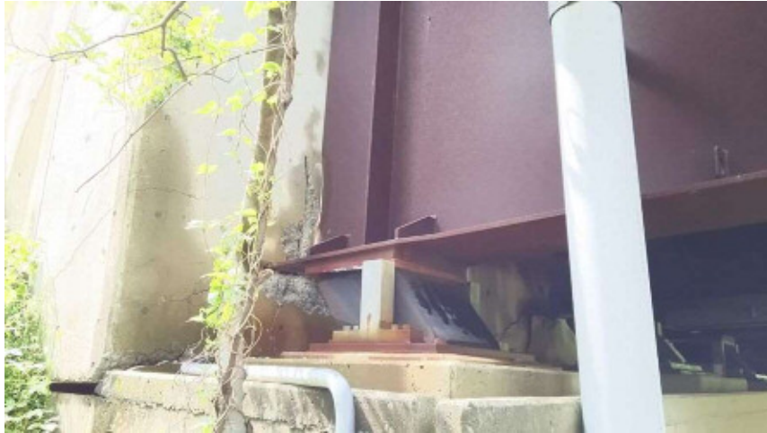
橋台の損傷 ゴム支承変形
