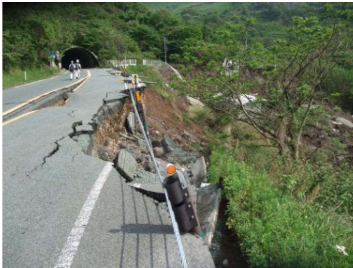
道路谷側斜面(盛土)の崩壊
