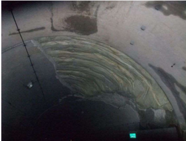
坑口から1600m付近 覆工コンクリートの剥落(防水シートの露出)
