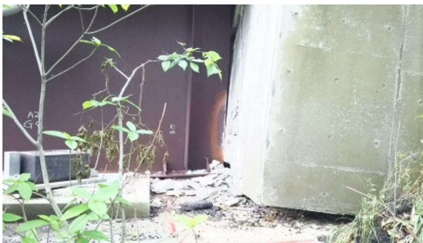
桁が橋台(胸壁)に衝突
