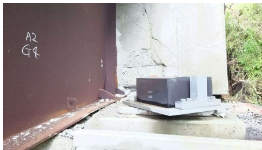
桁が支承から逸脱
